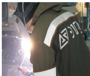
Участок сварочных постов
