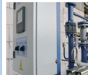
Участок монтажа КИП
